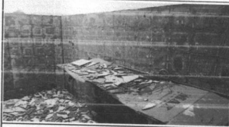
Demolição de revestimento cerâmico, de forma manual, sem reaproveitamento. af_09/2023. WC FEMININO
