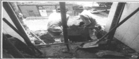
Escavação manual de vala ou cava em material de 2ª categoria, segunda etapa do memorial descritivo
