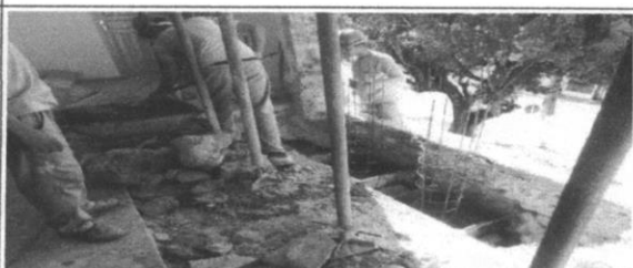
Escavação manual de vala ou cava em material de 2ª categoria, terceira etapa do memorial descritivo
