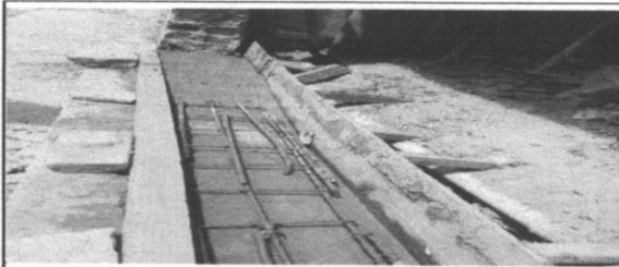
Lançamento de Concreto Armado fck=30,0 MPa na terceira etapa do memorial descritivo
