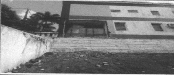
Demolição de alvenaria de tijolo maciço, de forma manual, sem reaproveitamento. Primeira Etapa conforme memorial descritivo.
