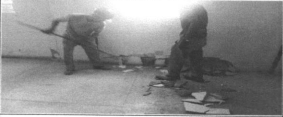
Demolição de alvenaria de tijolo maciço, de forma manual, sem reaproveitamento. Execução terceira etapa conforme memorial descritivo
