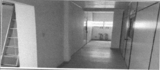
Pintura de acabamento com aplicação de 02 demãos de tinta PVA latex para interiores - cores convencionais - Rev 03
