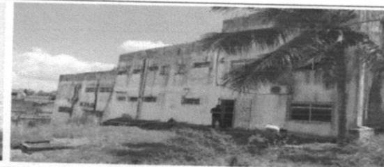
Pintura de acabamento com aplicação de 02 demãos de tinta PVA latex para exteriores
